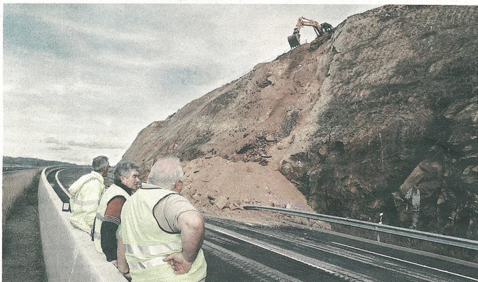
NUEVE HORAS SIN TRÁFICO | Operarios de la Xunta observan el efecto del desplome mientras una máquina retira escombros en el talud | PILI PROL
