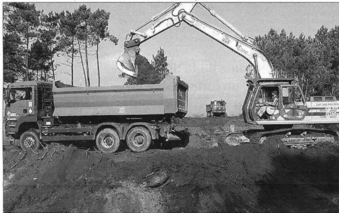
Comienzo del destierre de las obras de la Estación de Tratamiento de Agua Potable. // D.P.
